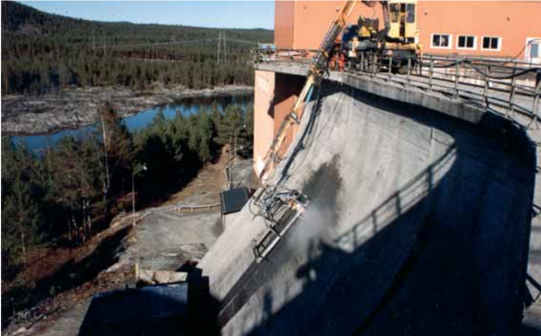
La retirada del hormigón permite eliminar la carbonatación de la estructura
