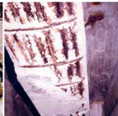
Corrosión de la armadura
