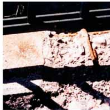
Sobrecargas y desgaste
