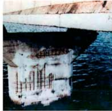
Tipo de hormigón inadecuado
